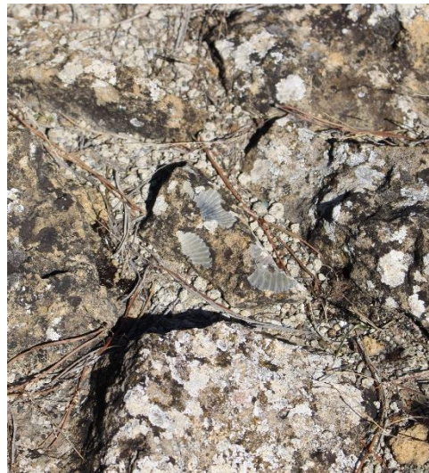
Fig. 12 - Presenza di conchiglie nella muratura. Foto scattata sulla sommità della sezione 48-49.
