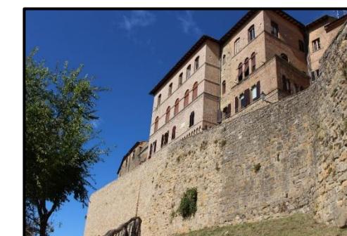
Fig. 23 – Vista della sezione 93 e parte ricostruita dopo il crollo del 2014
