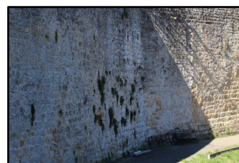
Fig. 21 – Vista della sezione 51 con presenza diffusa di vegetazione
