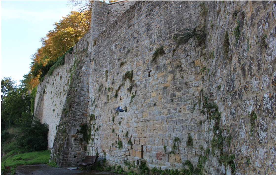
Figura 15: Presenza di una discontinuità geometrica dovuta a contrafforti, sezione 56.
