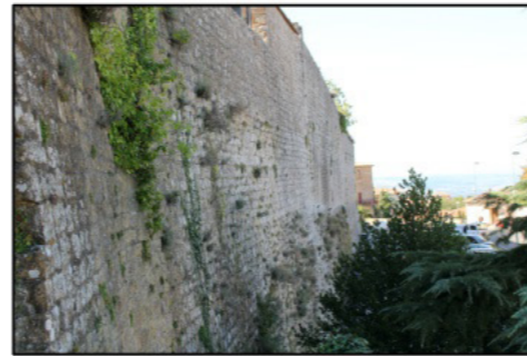
Fig.5: Vista della sezione 5-6 con presenza di vegetazione sul paramento murario
