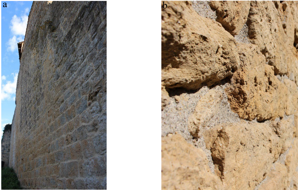
Figura 8: A sinistra, tessitura muraria con discromie. In particolare, si nota in basso la pietra caratteristica del territorio di Volterra. A destra, ingrandimento che mostra bene la natura della muratura di pietre volterrane.
