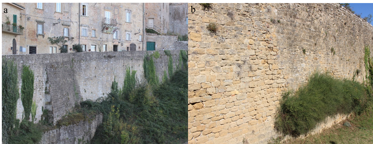
Figura 14: A sinistra, presenza di vegetazione su larga parte del paramento murario in corrispondenza dell'anfiteatro romano, sezioni 19-24. Si evidenzia anche una discontinuità geometrica. A destra, presenza di vegetazione specialmente in basso nella sezione 48-49.
