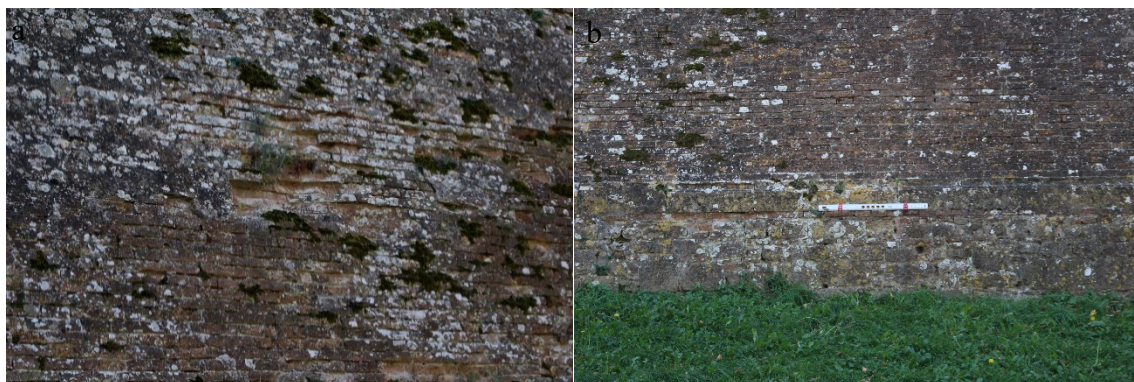
Figura 9: A sinistra, tessitura muraria caratterizzata da muratura in mattoni in cui si evidenzia un parziale crollo del paramento murario. A destra, discontinuità dovuta alla realizzazione di uno zoccolo con pietre squadrate di maggiori dimensioni (sezioni 30-35, bastione Porta Docciola).
