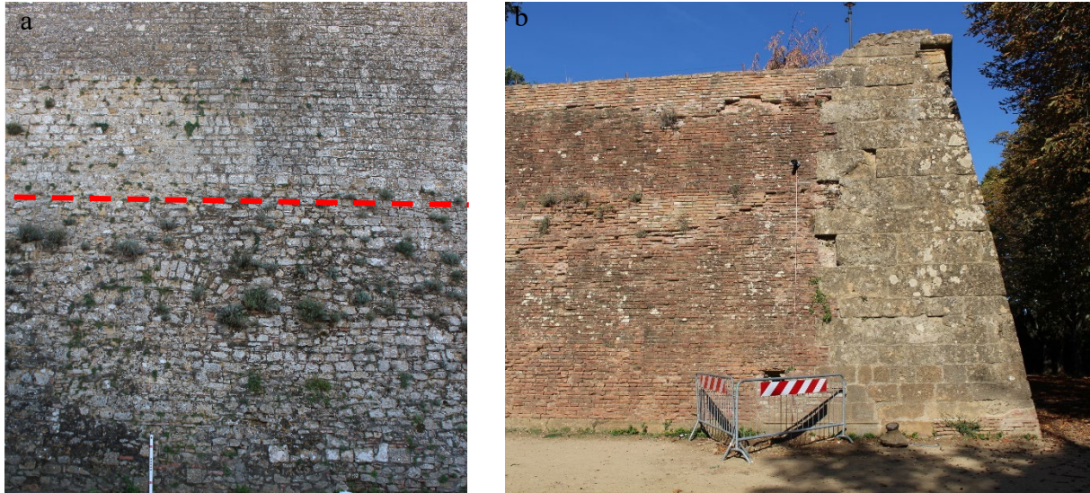
Figura 17: A sinistra, presenza di vegetazione sulla parte bassa del paramento murario. Inoltre, si mostra anche una discontinuità dovuta alla presenza di un arco in muratura (sezione 5-6). Si nota una diversa tessitura muraria a partire da una quota di circa 4 metri; la sopraelevazione è probabilmente dovuta ad un'evoluzione del tessuto urbano. A destra, presenza di una discontinuità muraria nell'angolo del bastione rinforzato con muratura squadrata di maggiori dimensioni. La muratura appare deteriorata in più parti (sezione 34-35). In particolare, si evidenziano aree con danneggiamento dei laterizi.
