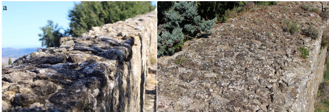
Figura 10: A sinistra, particolare che mostra la tessitura muraria in sommità del parapetto (sezione 59-60); a destra la sezione di sommità mostra il riempimento della sezione sempre in materiale di grossa pezzatura (sezione 48-49).
