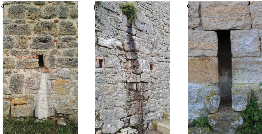
Figura 18: Da sinistra verso destra: sezione 92-93, 32-33, 51-52. In tutte le foto si evidenzia la presenza di dreni nel paramento murario. Nella foto al centro è visibile vegetazione che ostruisce parzialmente il dreno.
