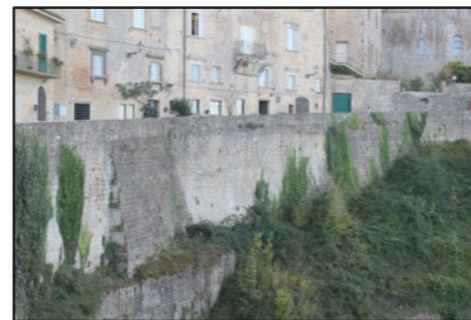
Fig.4: Vista della sezione 22, notevole presenza di vegetazione
