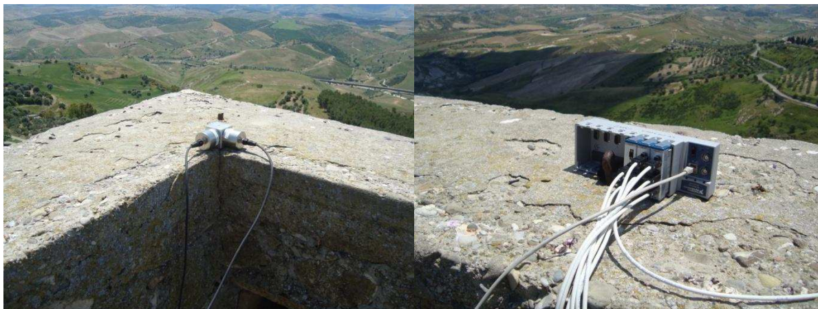
Figura 23 - Accelerometri piezoelettrici posizionati nell'angolo sud-est della copertura della torre a quota 21 m Figura 24 - DAQ 2 (modulo di acquisizione dati) posto a quota 21
