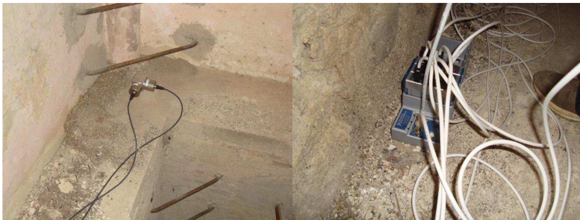
Figura 21 - Accelerometri piezoelettrici posizionati nell'angolo sud-ovest della torre a quota 12,5 m Figura 22 - DAQ 1 (modulo di acquisizione dati) posto a quota 12,5 m
